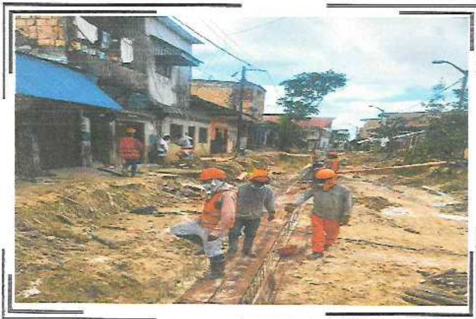
ENCOFRADO DE LOSA SUPERIOR DEL CAVA! DE 0.50 X 0.50 DEL PSJ. QUIÑONES TRAMO I
