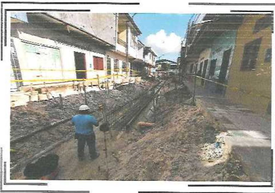
COLACION DE COTAS DE FONDO DE CANAL PROYECTADO DE 0.60X 0.60 DEL PSJ. GONZALES VIGIL
