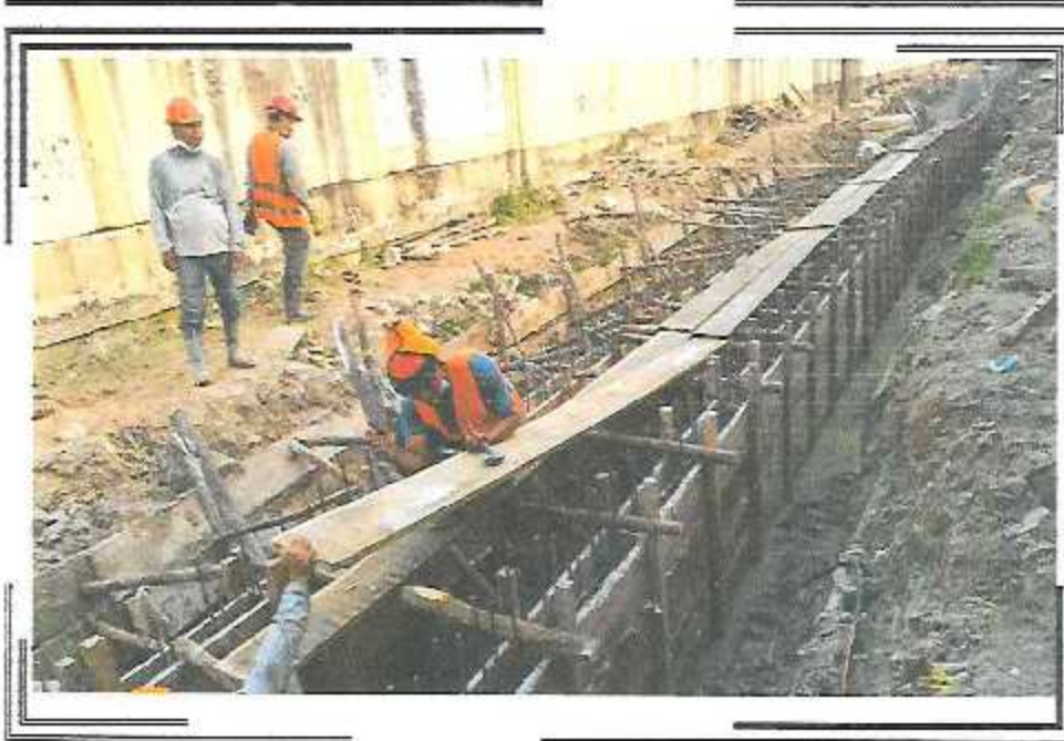
HABILITACION DE ENCOFRADO DE LOSA INFERIOR DEL CANAL DE 1.00 X 1.00 EN EL PSJ. QUIÑONES TRAMO I
