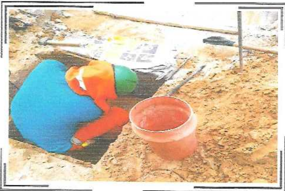
CONEXIONES DOMICILIARIAS DE TUBERIA DE PVC DE 200 mm. DEL PSJ. QUIÑONES TRAMO I
